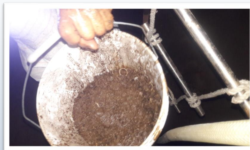
熱水槽內部鐵屑
