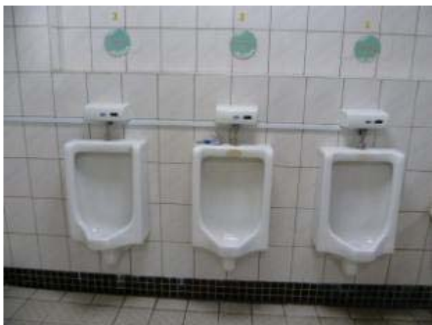
小便斗自動沖水器
